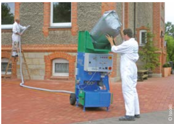
Befüllen der Zellulosemaschine
