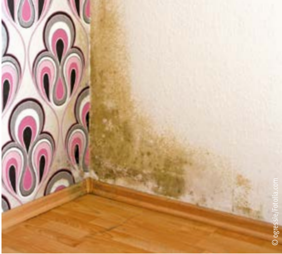
Schimmelbefall im Wohnbereich
