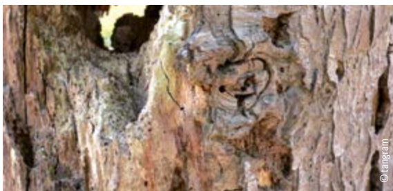
Holzschäden durch Schädlinge
