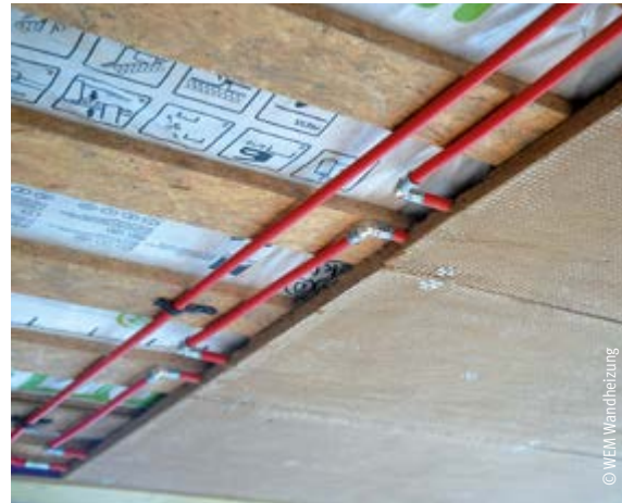
Deckenheizung und -kühlung mit in Lehm-Platten integriertem Rohrsystem (WEM-Klimaplatzen)
