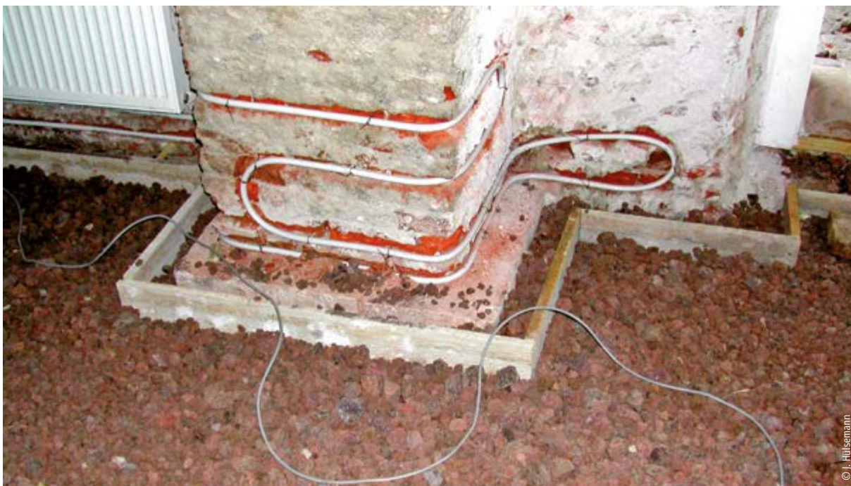
Bauteilheizung zur Trockenlegung von Außenwänden
