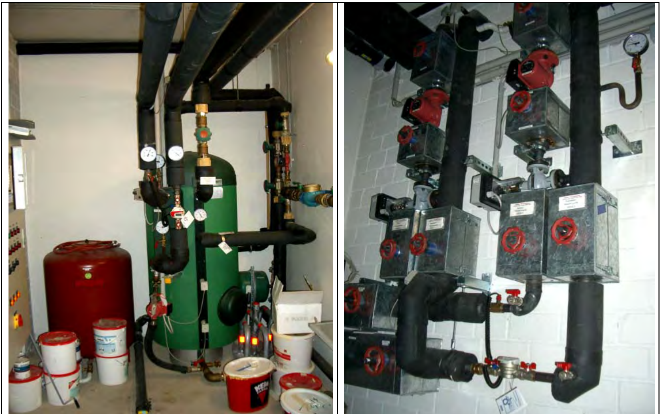
Bild 45 Fotos von zwei aufgenommenen Heizungskellern
