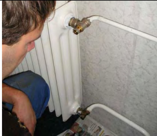
Neue voreinstellbare Thermostatventil werden bei Bedarf installiert.
