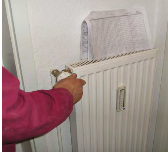
Aufsetzen des Ventilkopfes, nachdem der berechnete Voreinstellwert (nach Programmausdruck) eingestellt wurde.
