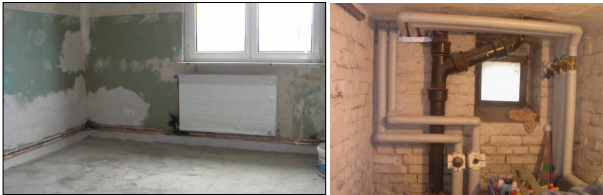
Bild 36 Heiznetz im beheizten Bereich, Steigepunkt aller Netze im Keller
