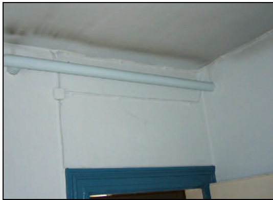
Bild 56 großformatige Rohre der ehemaligen Schwerkraftheizung
