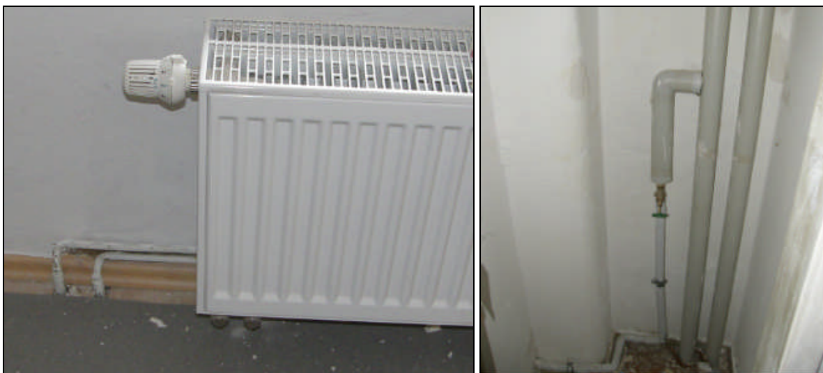
Bild 43 Heizkörperanschluss und Abzweig der Stichleitung TWW im Obergeschoss
