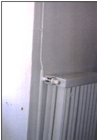
Bild 64 Vorlaufleitung im Dachgeschoss mit Entlüftung zum oben liegenden Hochbehälter
