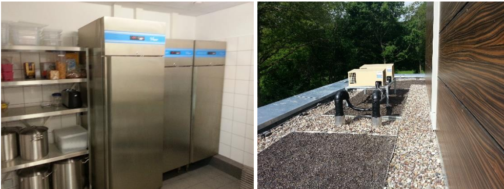
Abbildung 8 Kühlschränke im Küchenbereich EG (links) und Außenaufstellung der Rückkühlleinheiten auf dem Dach (Kita Robinienweg)
