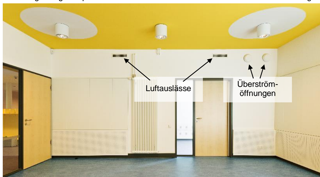
Abbildung 6 Lüftungsauslässe in den Gruppenräumen (Kita Posthornstraße)
