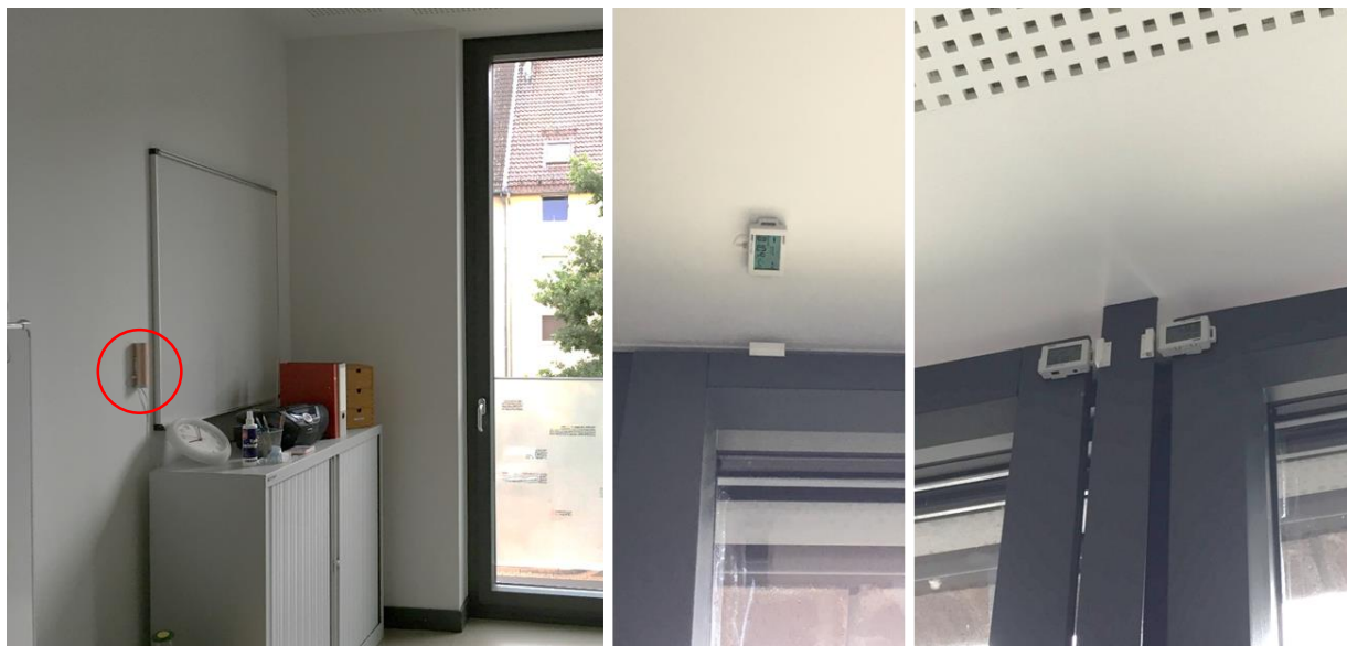
Abbildung 4: Anbringung der Messgeräte im Raum AUR 1, Fichteschule
