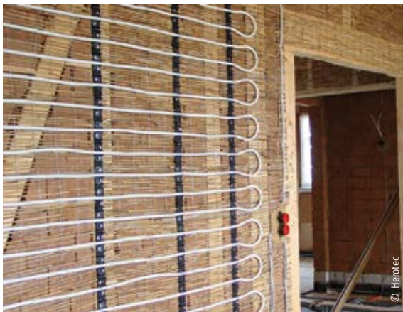
Heizrohrsystem auf Schilfrohmatten
