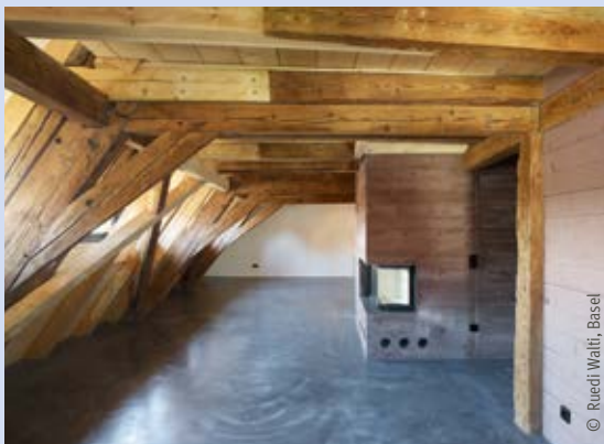
Instandsetzung des Fachwerks unter denkmalpflegerischen Gesichtspunkten. Innendämmung mit 8 cm Holzfaserdämmplatte und Kalk-/Lehmputz
