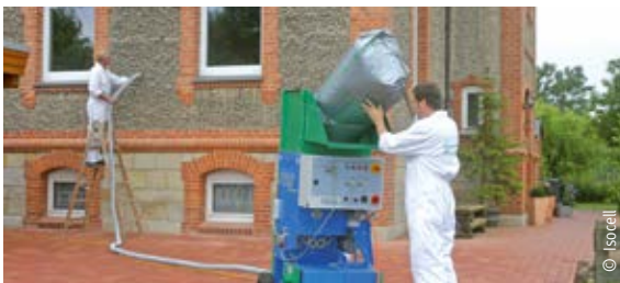
Befüllen der Zellulosemaschine
