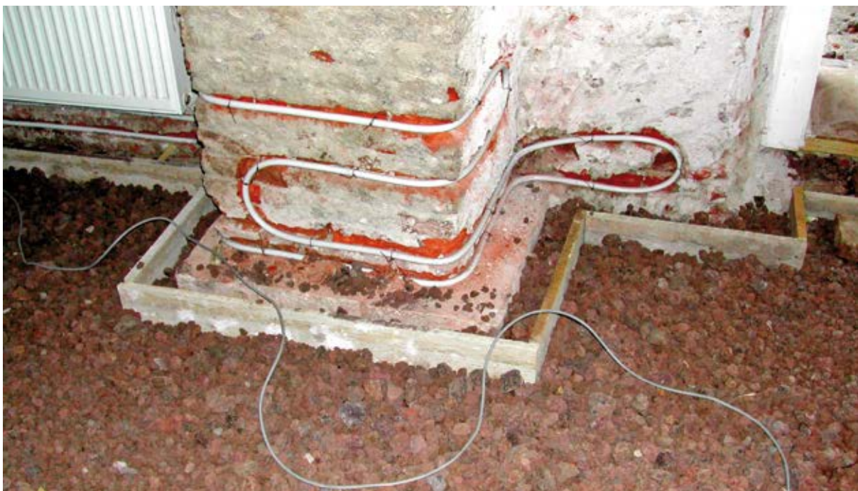
Bauteilheizung zur Trockenlegung von Außenwänden
