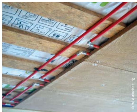
Deckenheizung und -kühlung mit in Lehm-Platten integriertem Rohrsystem (WEM-Klimaplatte)
