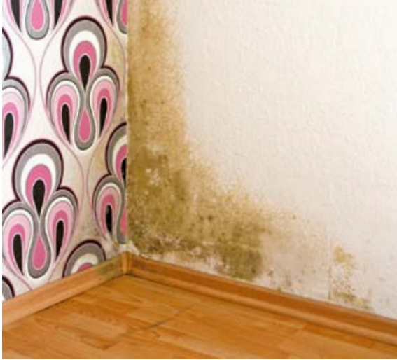
Schimmelbefall im Wohnbereich
