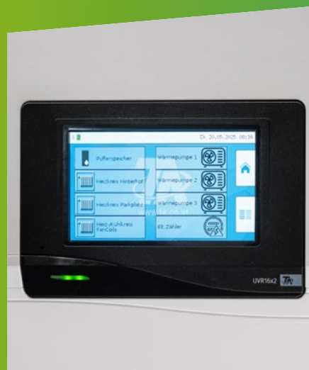
Intelligentes Regelungssystem für die Wärmepumpen, die PV-Anlage und den Batteriespeicher
