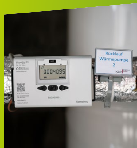
Wärmemengenzähler der Wärmepumpe 2
