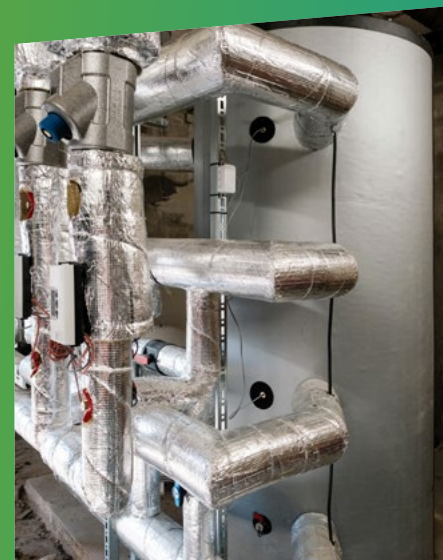
Heizungs-Pufferspeicher mit gut gedämmten Verteilungen
