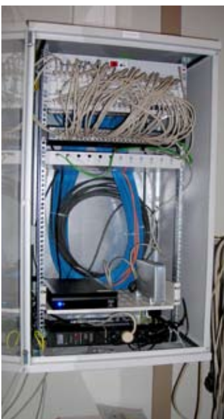
Der Thin Client Server der IGS-Linden
