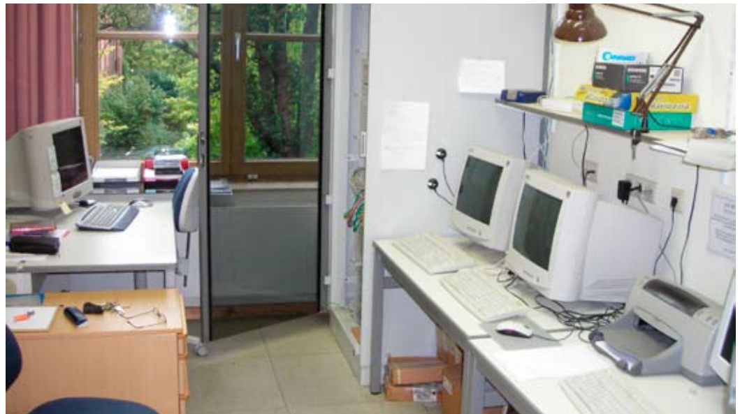
Serverraum der Michelsenschule in Hildesheim
