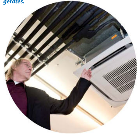
Der Energieberater Thomas Nagel demonstriert die Funktion eines Deckenumluftgerätes.
